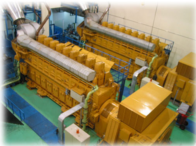
El interior de la planta de energía de Textafil IV: 2 x 9CM43 - combustible de petróleo pesado generando 15.7 MW - cogeneración y petróleo termal.
