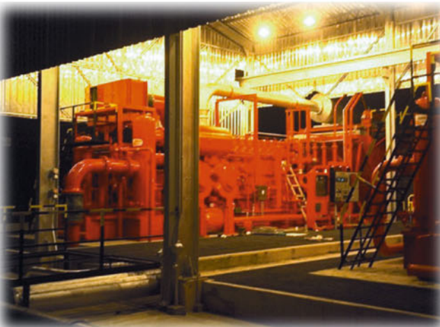
Cuatro motores G3608 de CAT® conduciendo compresores de Dresser Rand en Provincia, Colombia, en la estación de Ecopetrol. Estos compresores proveen gas a la ciudad de Bucaramanga para el consumo doméstico y a la refinera en Barrancabermeja.
