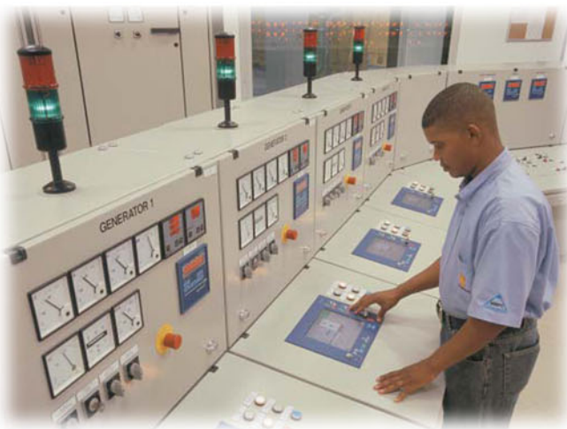
Sala de control en una de las plantas de energía que Energy International construyó y actualmente opera.
