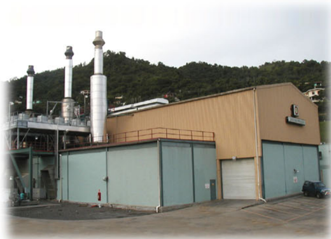
Planta de energía de Grenlec-Quenn en St. George, Granada generando 18.4 kW.
